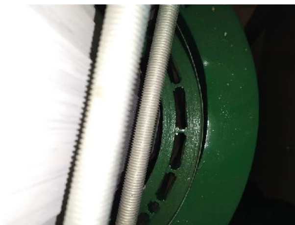
Esta falha confirmou-se um deslocamento do núcleo do transformador.
